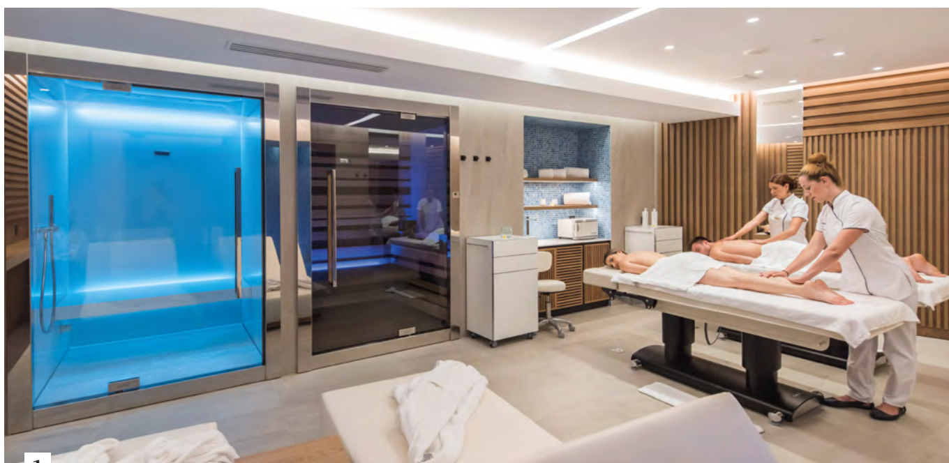
1. Nana Princess (Crete): couple wellness treatment in the Beauty area equipped with sauna and steam bath from the Starpool Sweet Collection. Nana Princess (Creta): trattamento benessere di coppia nell'area Beauty attrezzata con sauna e bagno di vapore della collezione Sweet di Starpool.
